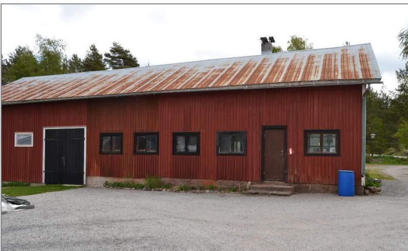
Kuva 21. Varasto- ja hallirakennuksen alkuperäisen osan, kuvassa oikealla, sokkeli on lohkokiveä. Rakennuksen katteena on aaltopelti.
